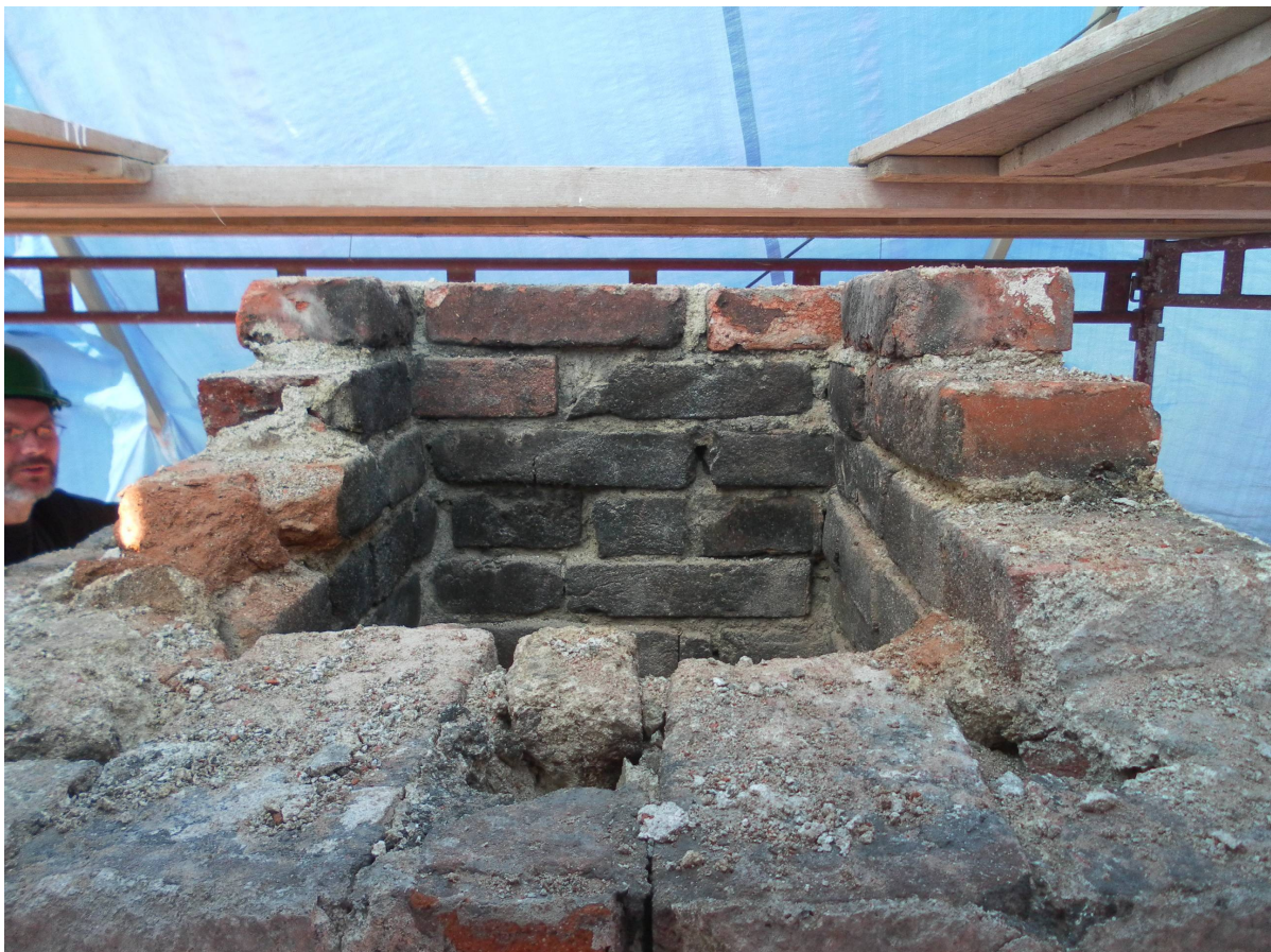
Statická porucha komínu – chybějící vrchní část
