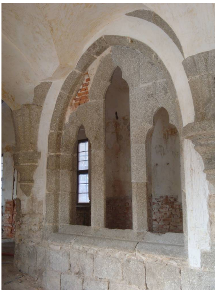
Část okenní stěny jižního křídla ambitu byla rekonstruována v roce 1969. Části tehdy postavené z cihel jsou nyní překrývány kamennou deskou.
