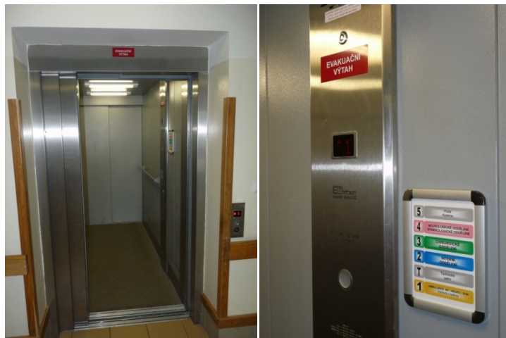
Obrázek 21. Výtah v hlavní budově
