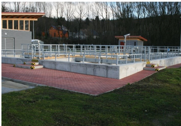
mechanicko-biologická ČOV Kostelec
