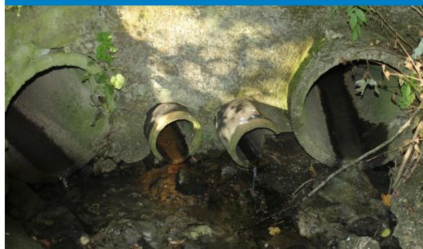
Heraltice – výusti pod ČOV
