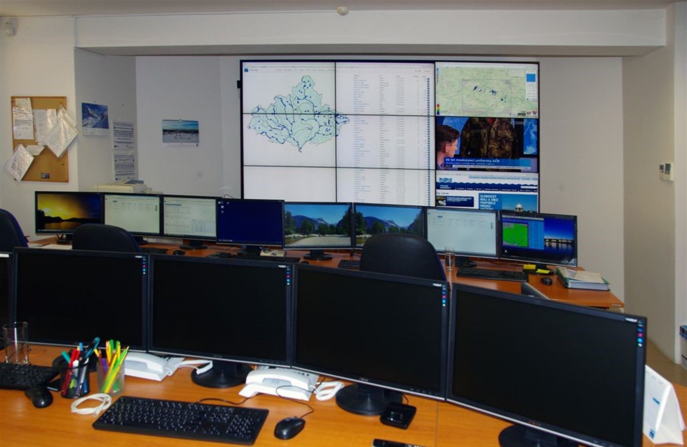
Místnost vodohospodářského dispečinku
